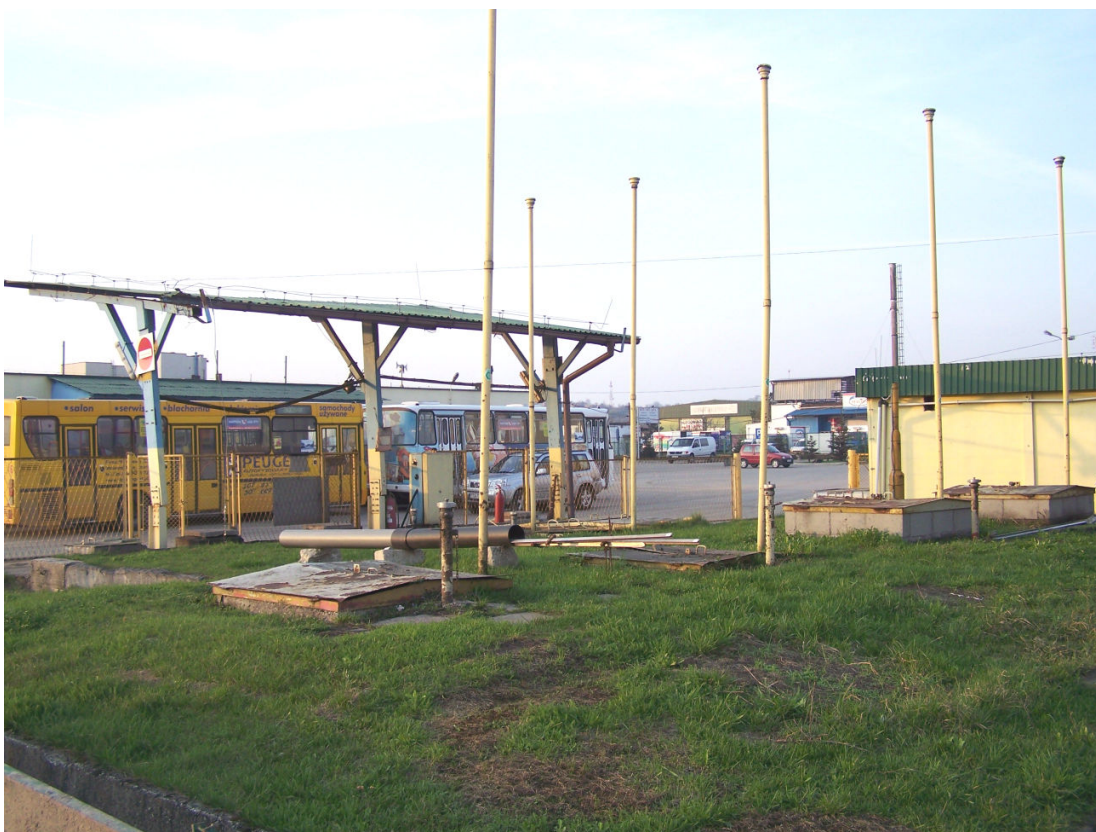
fot. 8 Zagospodarowanie terenu zbiorników na paliwa z instalacjami i armaturą
