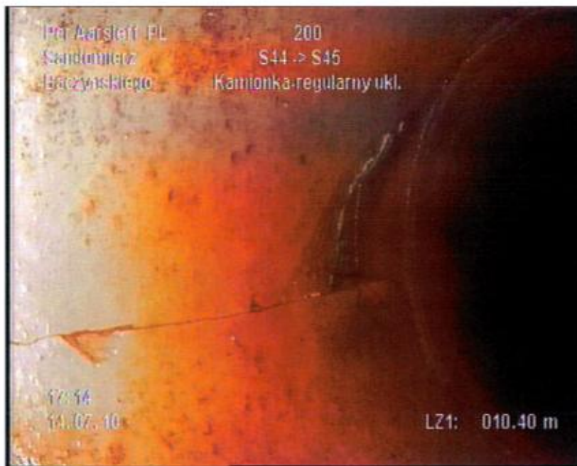
Zdjęcie: 39_4A 10,4m, Pęknięcie wzdłużne, o 12 godzina
