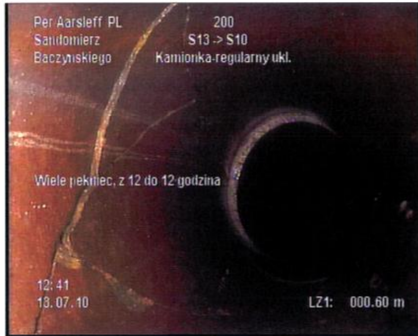
Zdjęcie: 12_2A 0,6m, Wiele pęknięć, z 12 do 12 godzina
