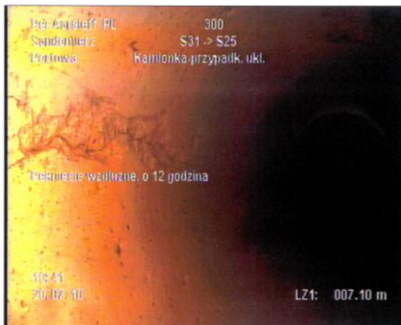
Zdjęcie: 20_5A 7,1m, Pęknięcie wzdłużne, o 12 godzina
