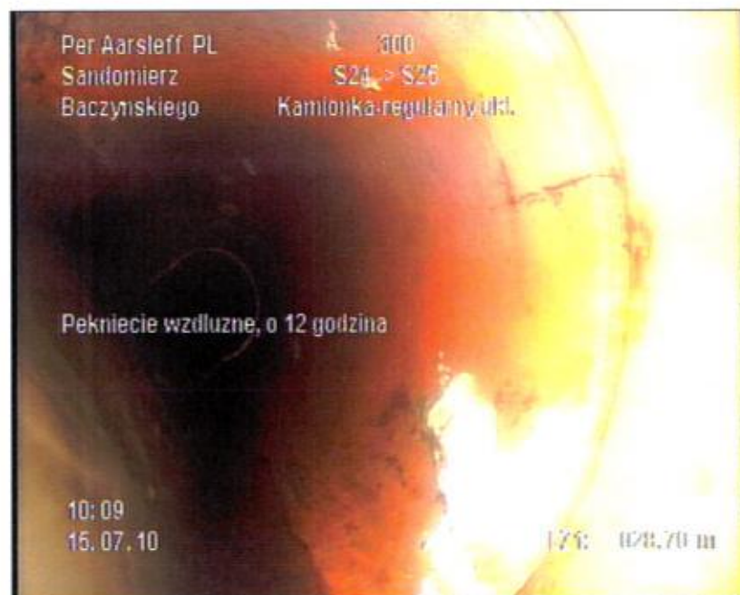
Zdjęcie: 44_5A 28,7m, Pęknięcie wzdłużne, o 12 godzina
