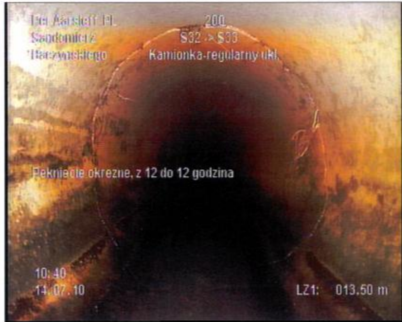
Zdjęcie: 25_10A 13,5m, Pęknięcie okrężne, z 12 do 12 godzina
