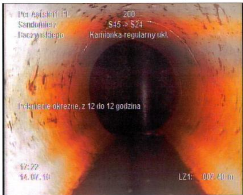
Zdjęcie: 40_2A 7,4m, Pęknięcie okrężne, z 12 do 12 godzina
