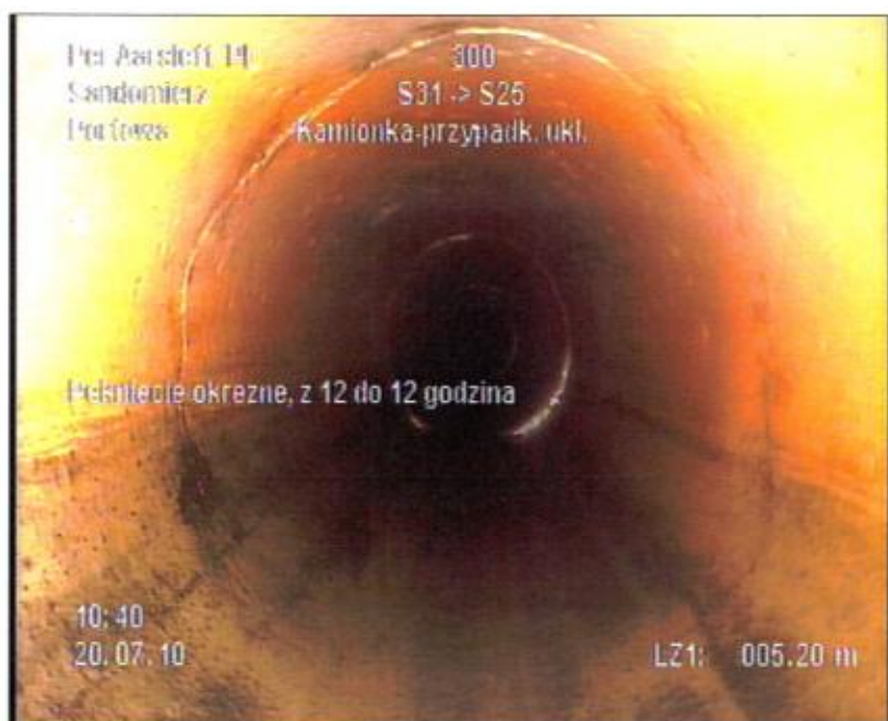
Zdjęcie: 20_3A 5,2m, Pęknięcie okrężne, z 12 do 12 godzina
