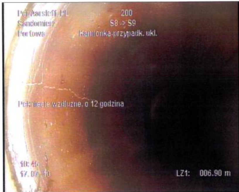
Zdjęcie: 7_6A 6,9m, Pęknięcie wzdłużne, o 12 godzina
