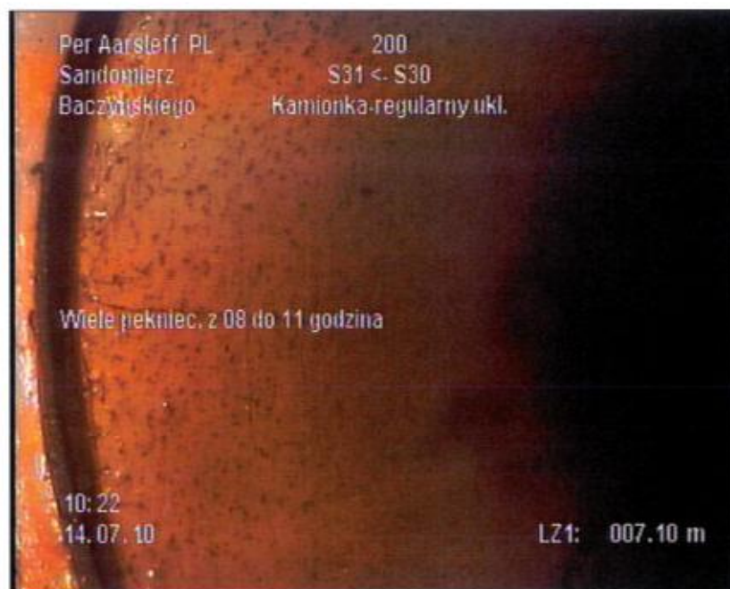
Zdjęcie: 24_3A 7,1m, Wiele pęknięć, z 08 do 11 godzina
