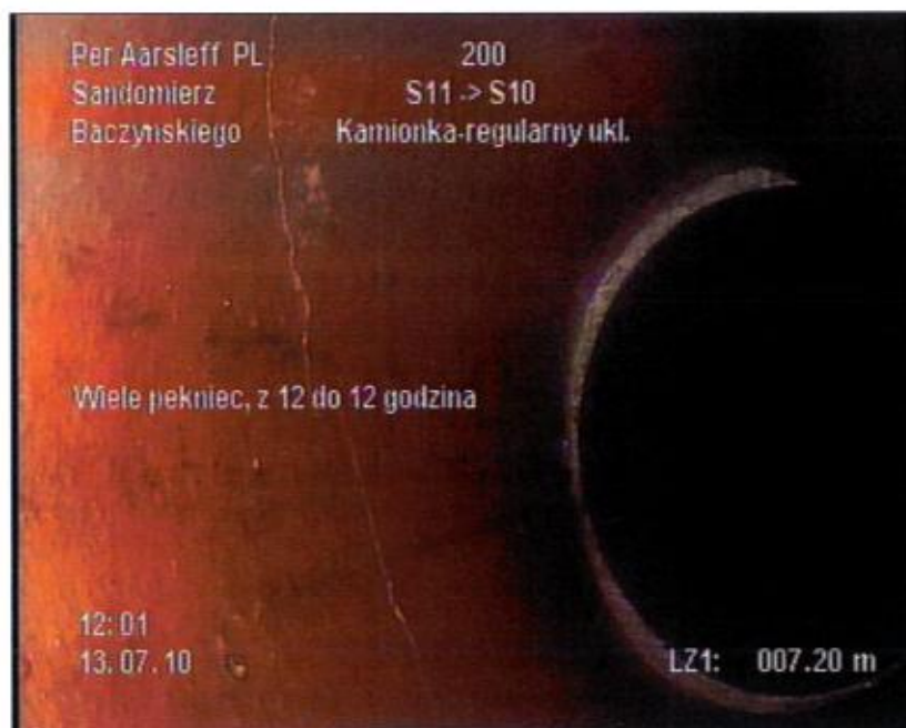
Zdjęcie: 9_4A 7,2m, Wiele pęknięć, z 12 do 12 godzina
