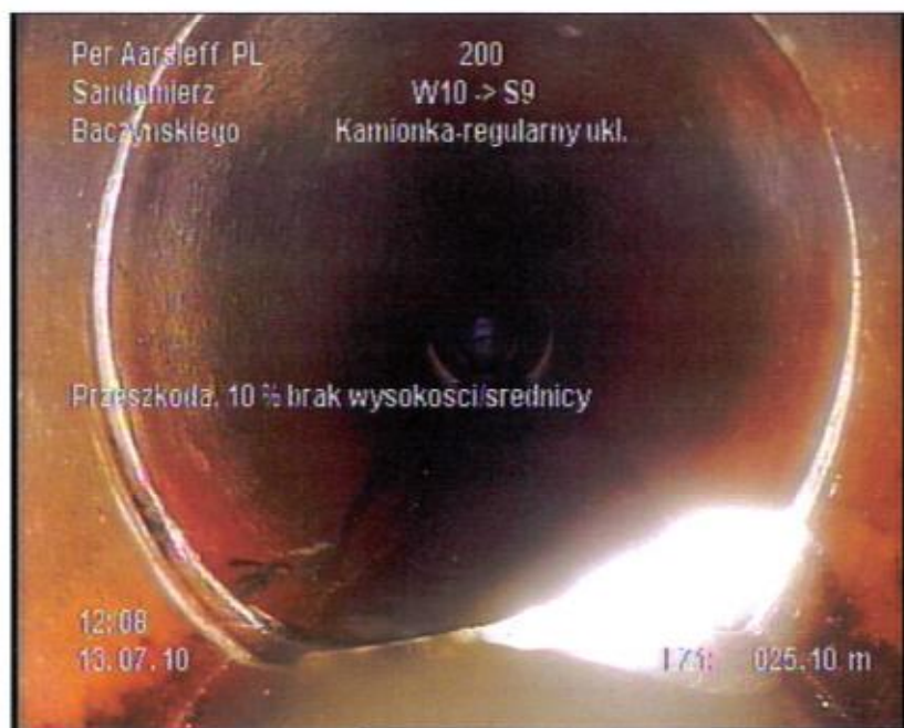
Zdjęcie: 10_4A 25,1m, Przeszkoda, 10 % brak wysokości/średnicy
