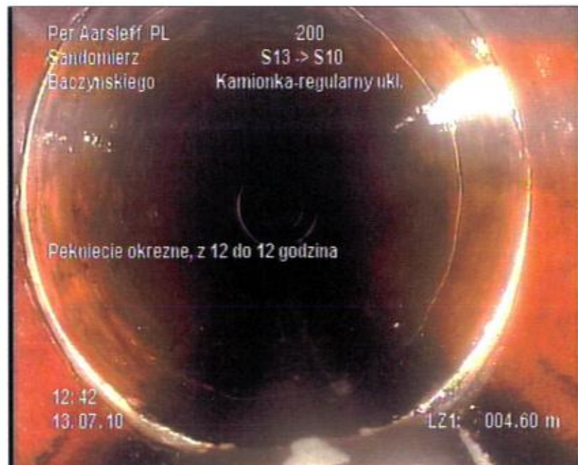
Zdjęcie: 12_3A 4,6m, Pęknięcie okrężne, z 12 do 12 godzina
