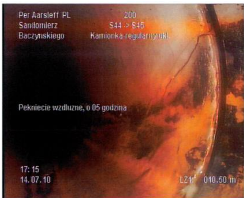
Zdjęcie: 39_5A 10,5m, Pęknięcie wzdłużne, o 05 godzina
