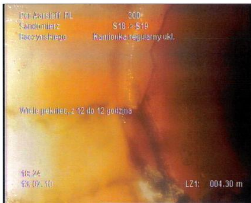
Zdjęcie: 18_4A 4,3m, Wiele pęknięć, z 12 do 12 godzina
