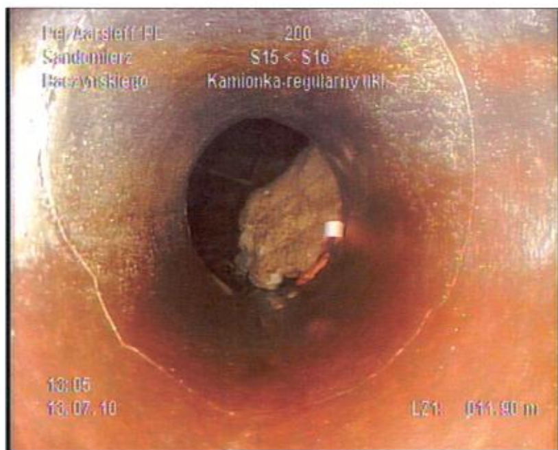
Zdjęcie: 14_1A 11,9m, Pęknięcie okrężne, z 12 do 12 godzina
