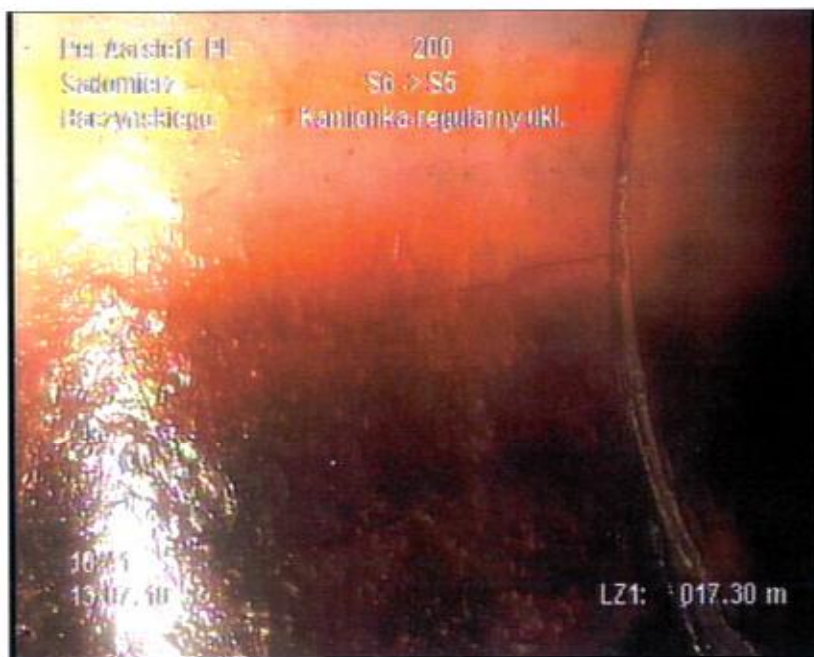
Zdjęcie: 5_2A 17,3m, Pęknięcie wzdłużne, o 09 godzina
