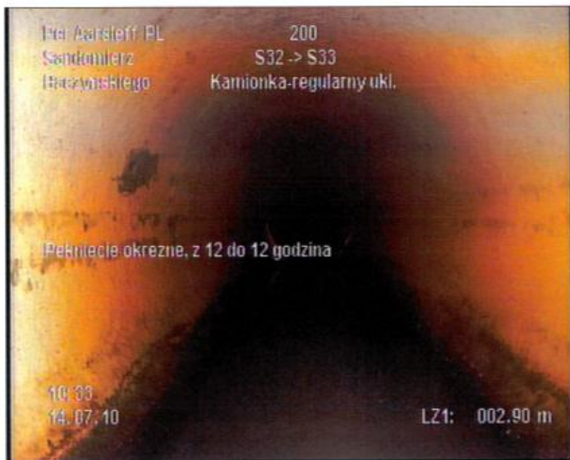
Zdjęcie: 25_4A 2,9m, Pęknięcie okrężne, z 12 do 12 godzina
