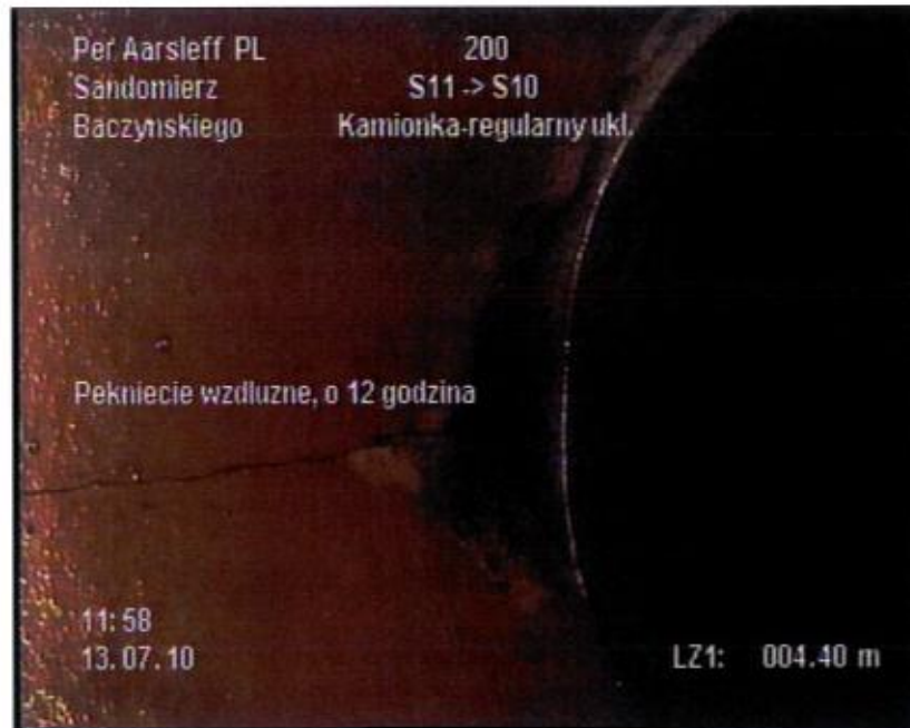
Zdjęcie: 9_2A 4,4m, Pęknięcie wzdłużne, o 12 godzina
