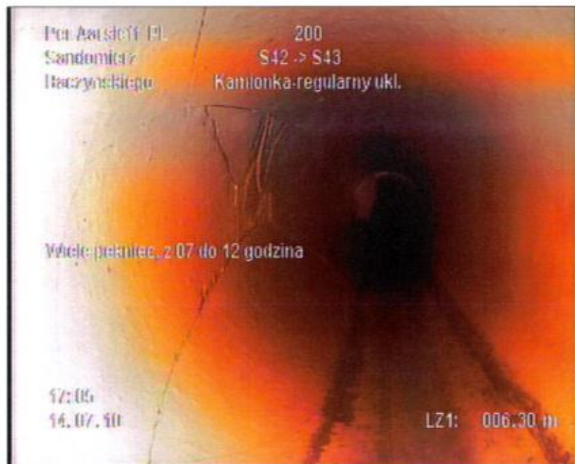
Zdjęcie: 37_3A 6,3m, Wiele pęknięć, z 07 do 12 godzina
