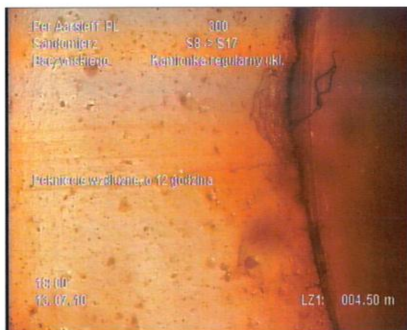
Zdjęcie: 16_3A 4,5m, Pęknięcie wzdłużne, o 12 godzina
