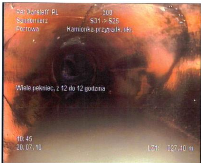
Zdjęcie: 20_9A 27,4m, Wiele pęknięć, z 12 do 12 godzina
