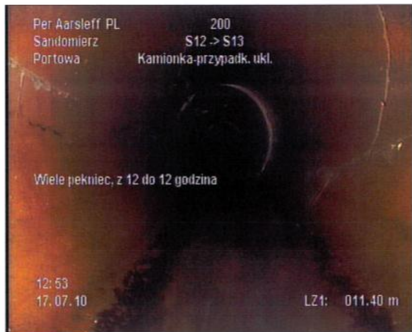
Zdjęcie: 11_5A 11,4m, Wiele pęknięć, z 12 do 12 godzina
