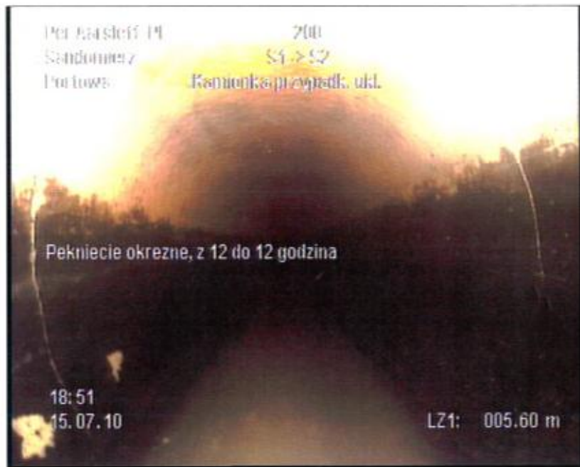
Zdjęcie: 1_4A 5,6m, Pęknięcie okrężne, z 12 do 12 godzina
