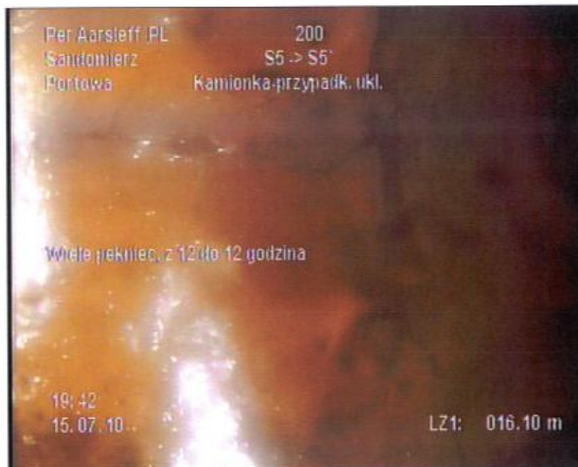
Zdjęcie: 5_5A 16,1m, Wiele pęknięć, z 12 do 12 godzina
