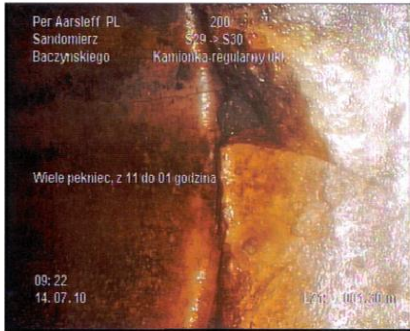
Zdjęcie: 22_2A 1,3m, Wiele pęknięć, z 11 do 01 godzina
