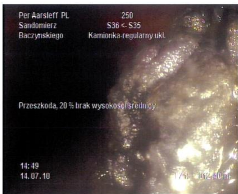
Zdjęcie: 32_5A 12,4m, Przeszkoda, 20 % brak wysokości/średnicy
