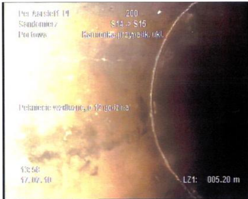
Zdjęcie: 13_2A 5,2m, Pęknięcie wzdłużne, o 12 godzina
