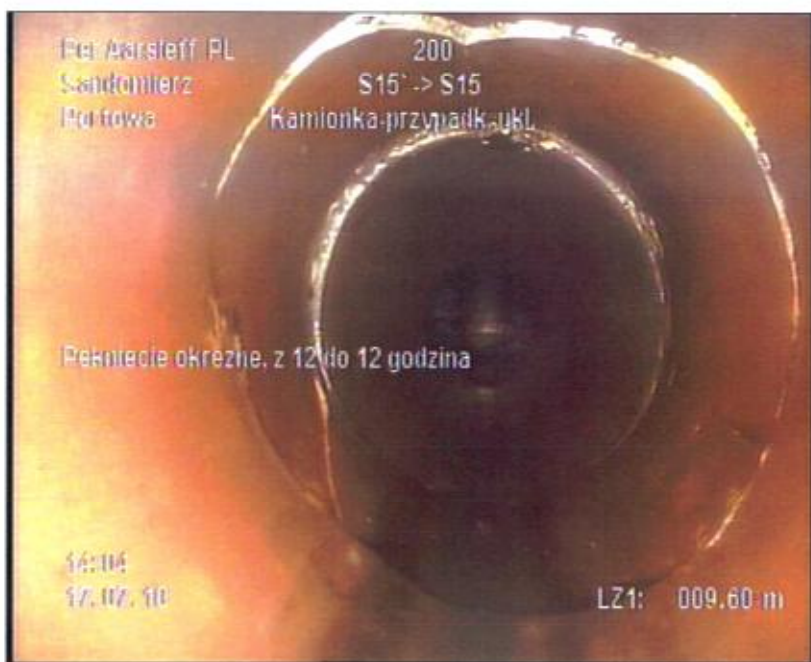
Zdjęcie: 14_5A 9,6m, Pęknięcie okrężne, z 12 do 12 godzina
