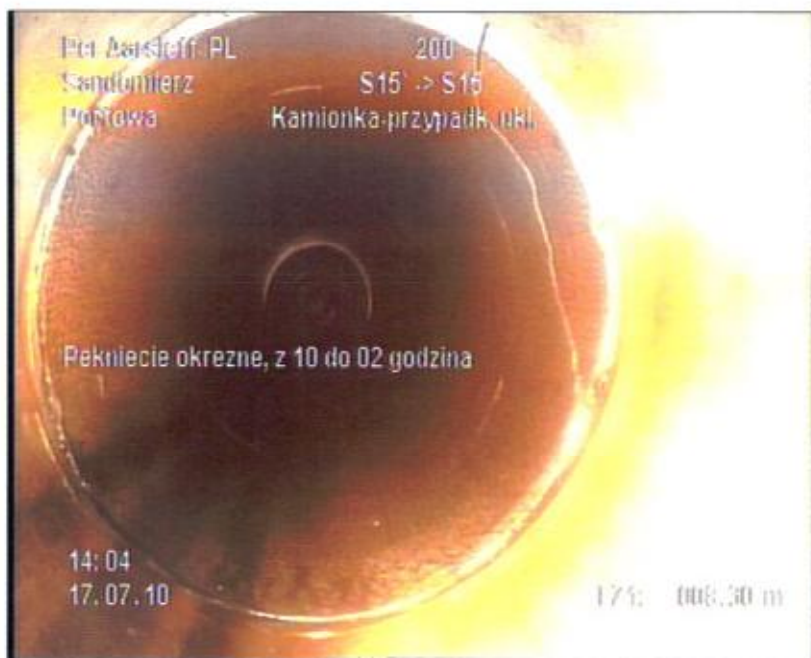
Zdjęcie: 14_4A 8,3m, Pęknięcie okrężne, z 10 do 02 godzina
