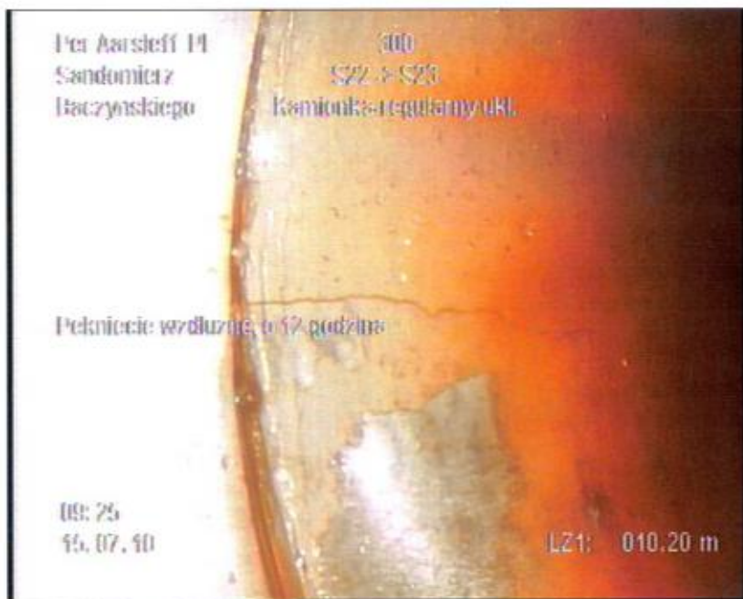
Zdjęcie: 42_2A 10,2m, Pęknięcie wzdłużne, o 12 godzina
