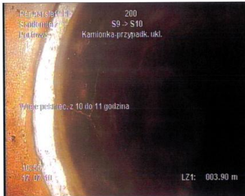
Zdjęcie: 8_2A 3,9m, Wiele pęknięć, z 10 do 11 godzina
