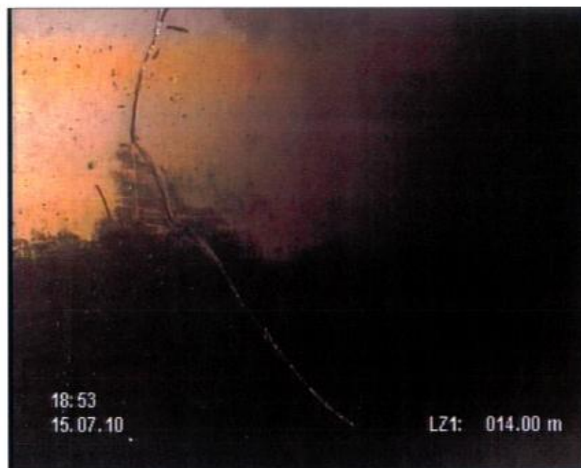
Zdjęcie: 1_5A 14m, Pęknięcie okrężne, z 12 do 12 godzina
