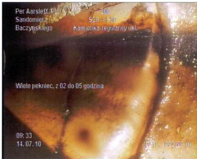
Zdjęcie: 22_3A 22,7m, Wiele pęknięć, z 02 do 05 godzina
