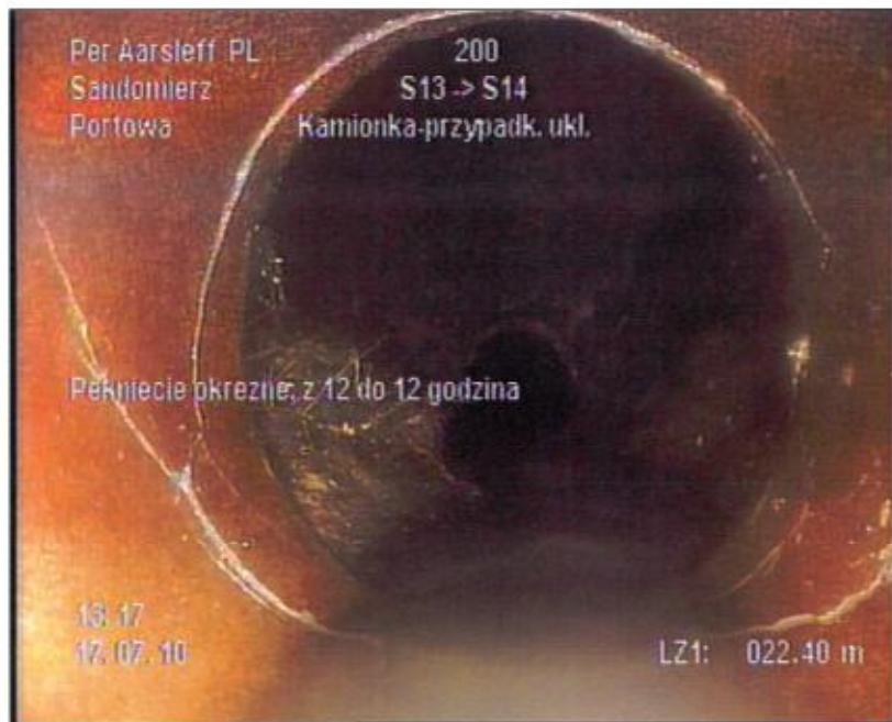
Zdjęcie: 12_5A 22,4m, Pęknięcie okrężne, z 12 do 12 godzina
