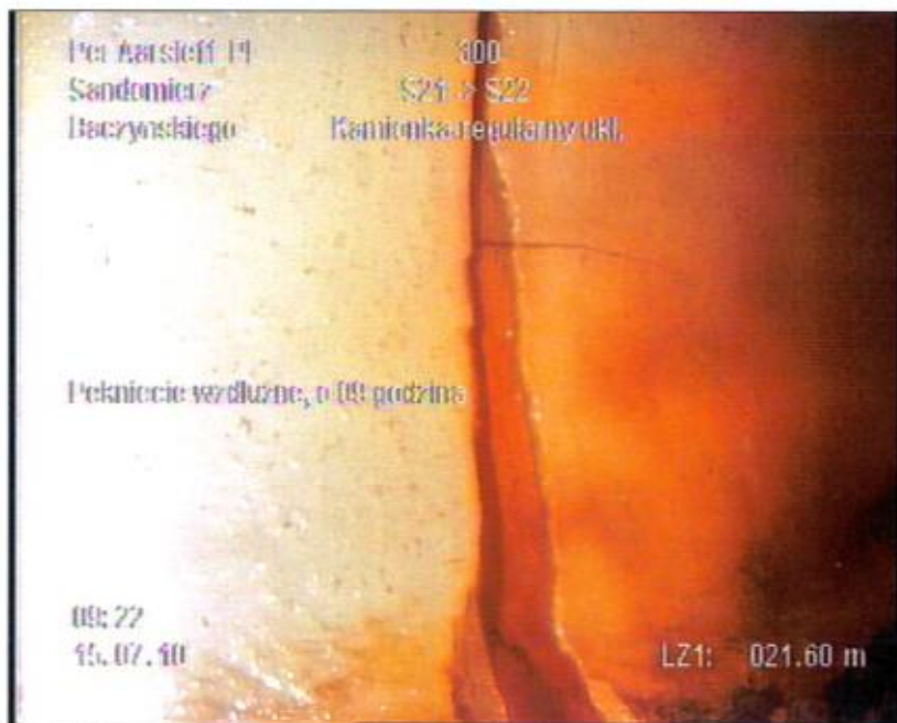
Zdjęcie: 41_4A 21,6m, Pęknięcie wzdłużne, o 09 godzina
