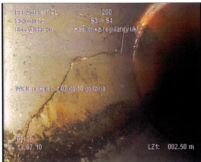
Zdjęcie: 3_2A 2,5m, Wiele pęknięć, z 07 do 10 godzina
