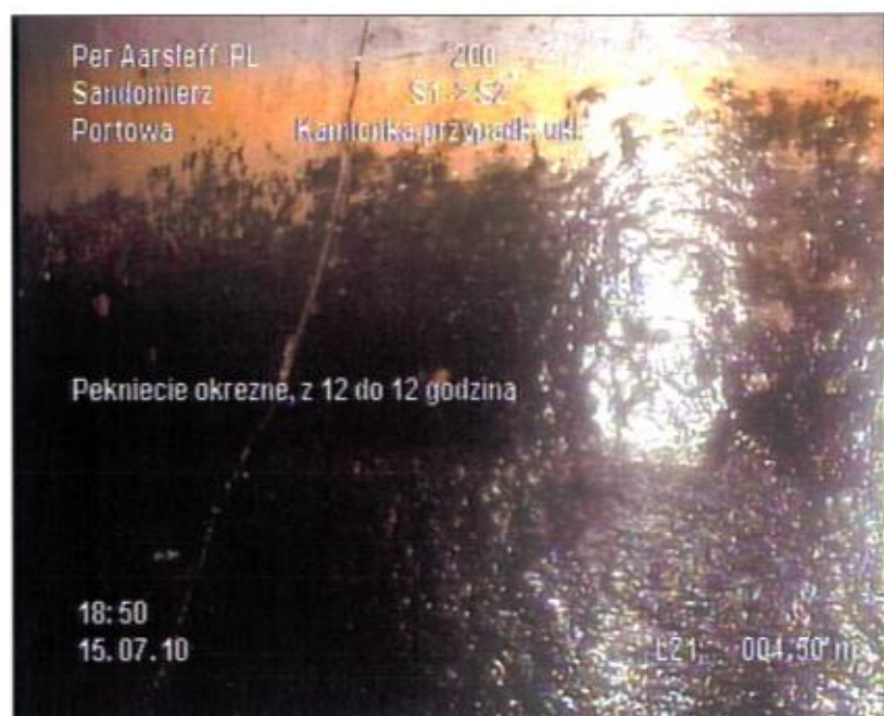
Zdjęcie: 1_3A 4,5m, Pęknięcie okrężne, z 12 do 12 godzina
