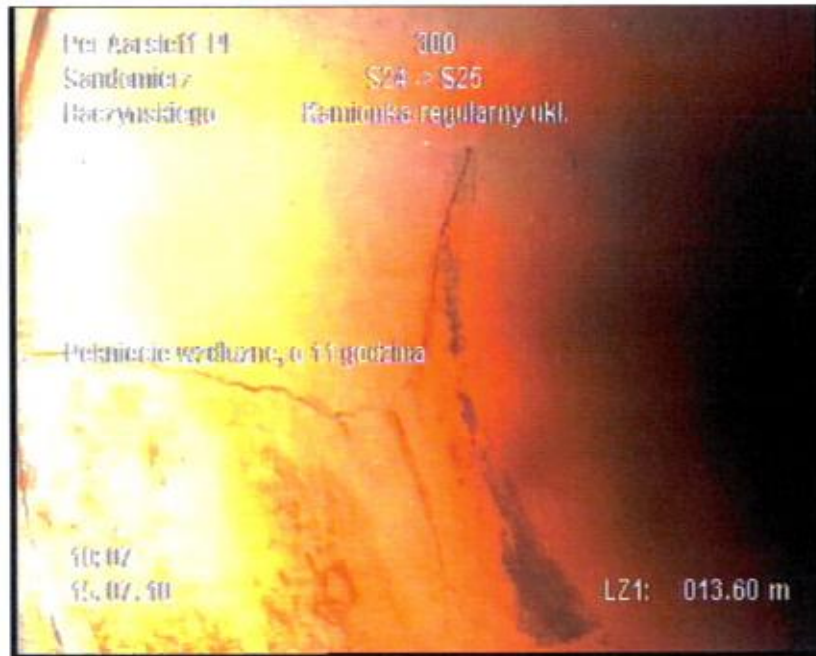
Zdjęcie: 44_4A 13,6m, Pęknięcie wzdłużne, o 11 godzina
