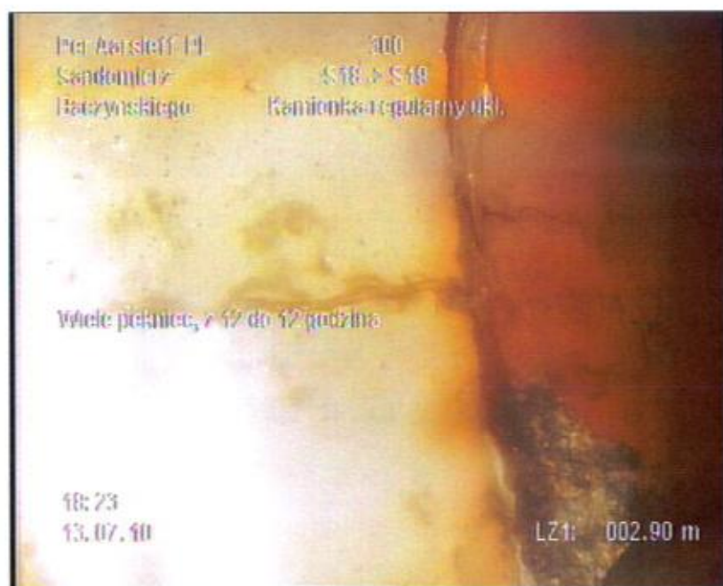
Zdjęcie: 18_3A 2,9m, Wiele pęknięć, z 12 do 12 godzina
