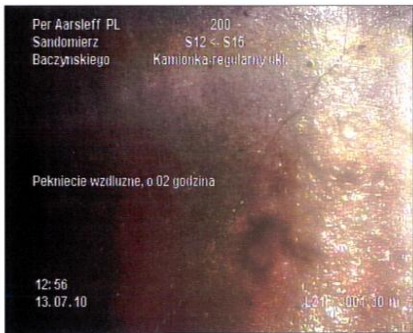
Zdjęcie: 13_2A 1,3m, Pęknięcie wzdłużne, o 02 godzina
