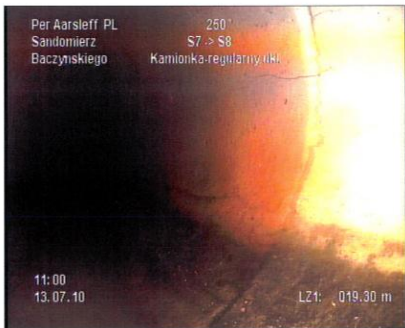
Zdjęcie: 7_3A 19,3m, Wiele pęknięć, z 02 do 03 godzina
