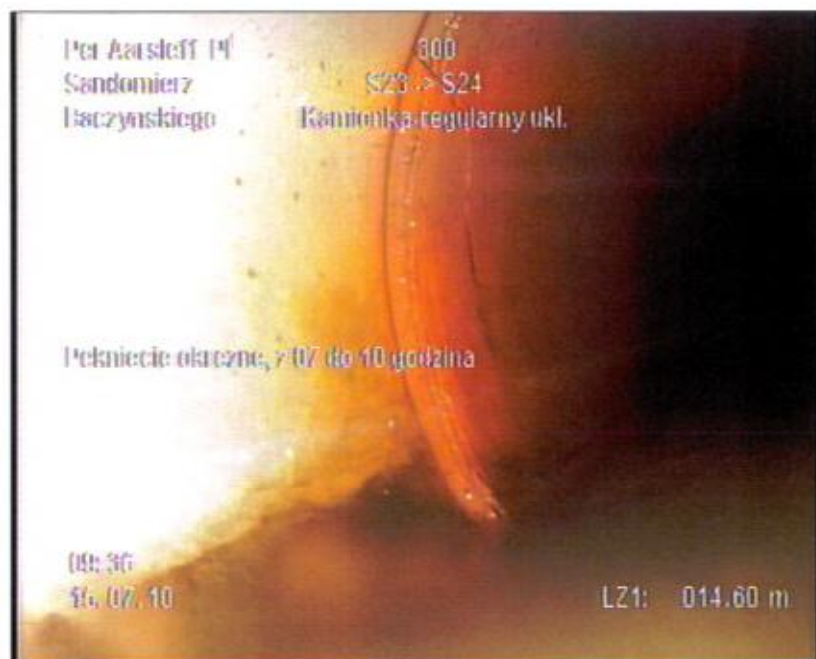
Zdjęcie: 43_3A 14,6m, Pęknięcie okrężne, z 07 do 10 godzina
